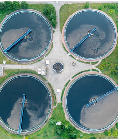
Plantas de tratamiento de agua
